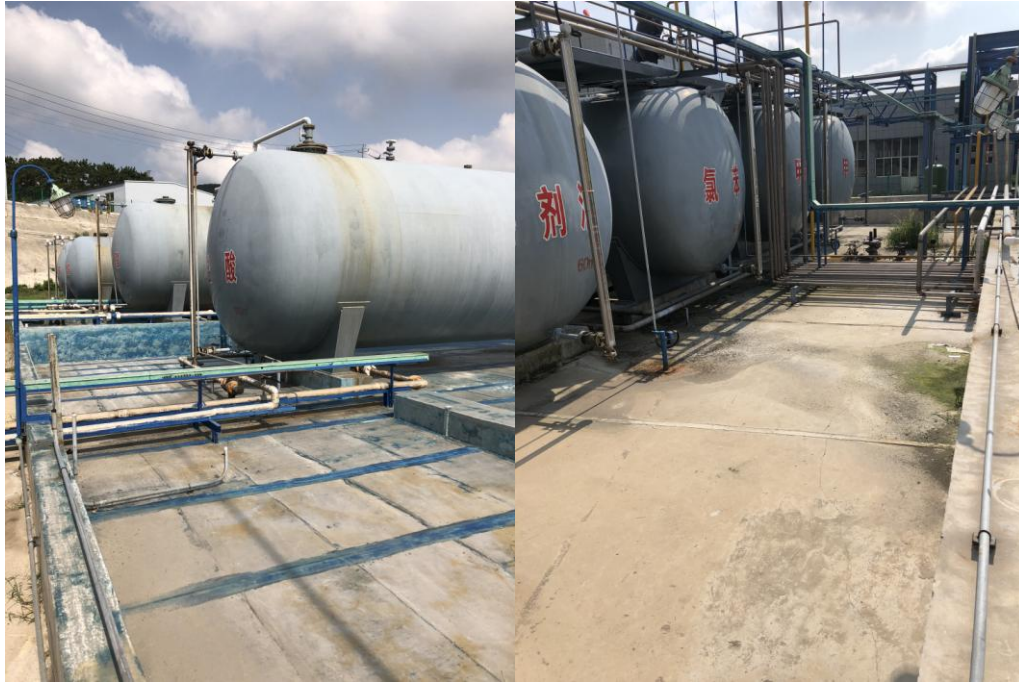
储罐区二级防泄漏图片
